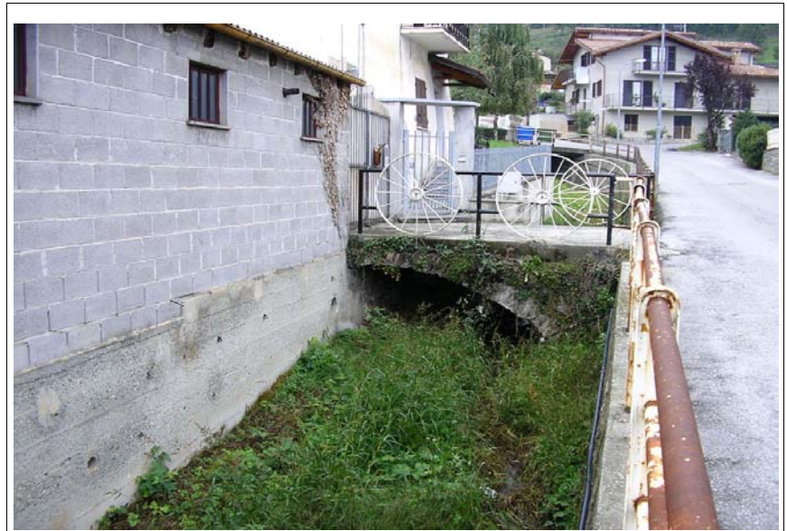
Foto 6 Sezione tipo del rio in cui è visibile l'ostruzione al deflusso offerta da un attraversamento
